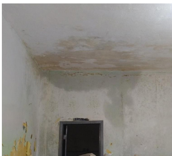
Figura 1. Mancha resultante infiltração laje Fonte: Santiago; Silva (2022).
