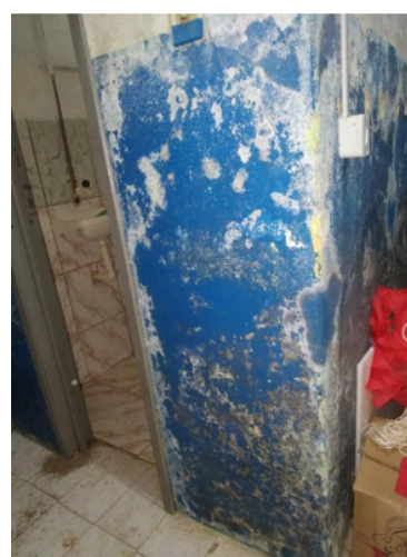
Figura 2. Parede como mofo, bolor e eflorescência Fonte: Santiago; Silva (2022).
